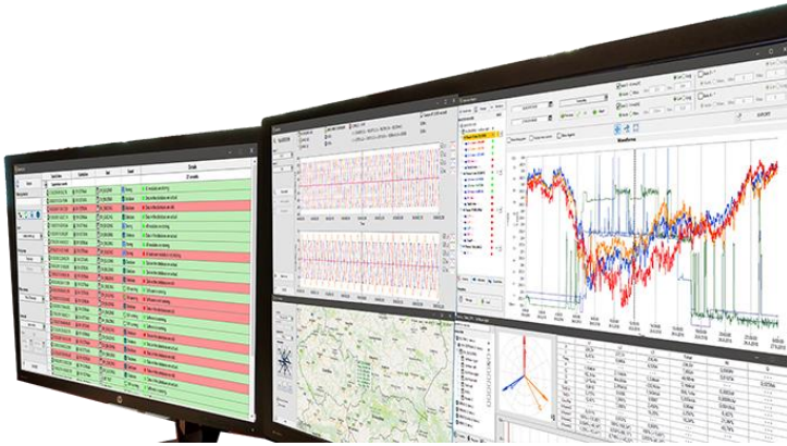
Abbildung 5: SCADA System ENA SCADA für die Leitwarte ( www.neo-messtechnik.com )
